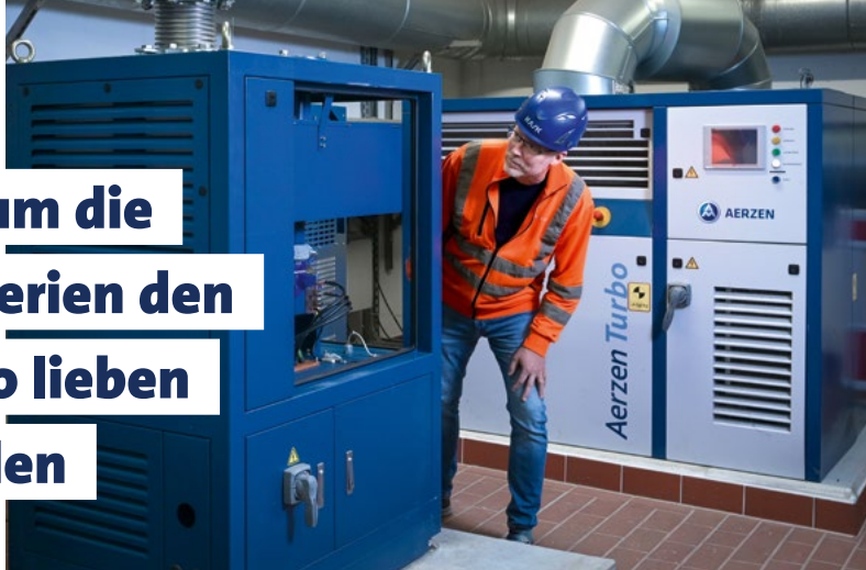
Baustellen-Inspektion: Mike Dragon sieht sich im Keller das neue Turbogebälse an.
