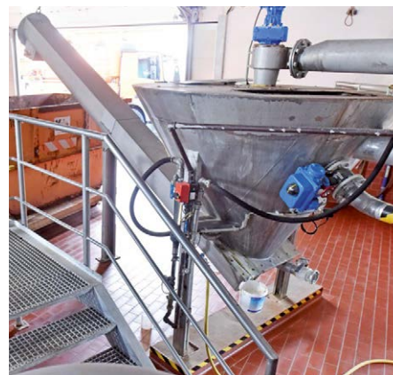
Die OEWA investiert viel Geld in einen neuen Sandfangklassierer.
