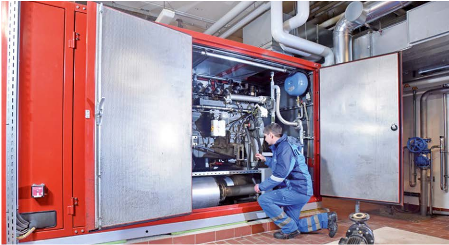
Genau hingeschaut: OEWA-Mitarbeiter Hagen-Erik Buch ist am BHKW beschäftigt.
